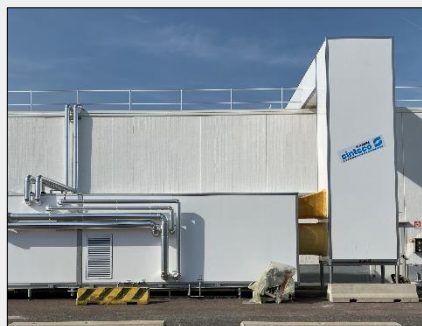
Completamente integrati con vestibolo - UTA e AERPAN®
